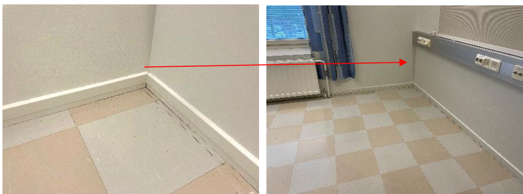
Kuva 2. Ilmaisus 1. Homekoira ilmaisi toimistohuoneessa 123 ulkonurkkaa lattian rakenneliitoksesta.
