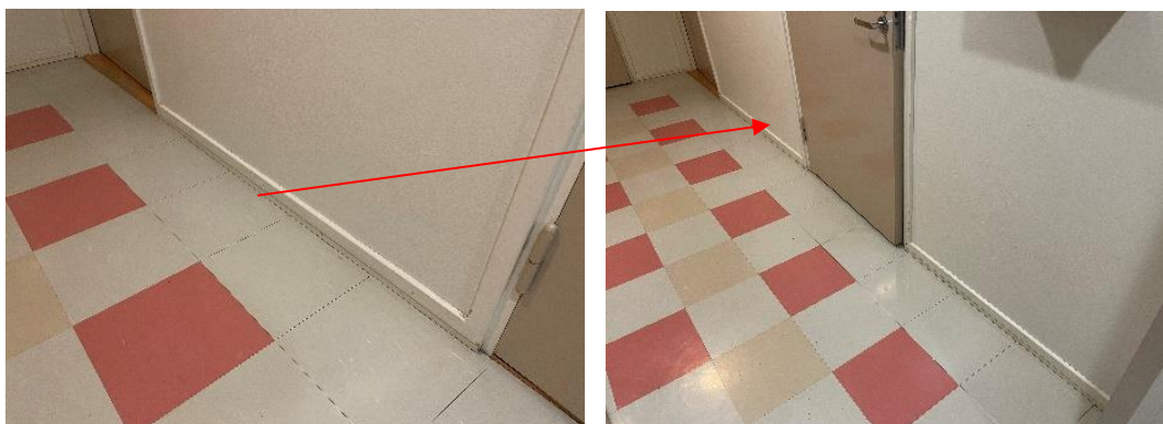
Kuva 3. Ilmaisus 2. Homekoira ilmaisi käytävällä 112_5 tilan 122 vastaista väliseinää lattian rakenneliitoksesta. Väliseinä (ei rakenneleikkauskuvaa saatavilla) on isännöitsijältä saadun tiedon mukaan kantava rakenne ja perustettu lattiapinnan alapuolelta.
